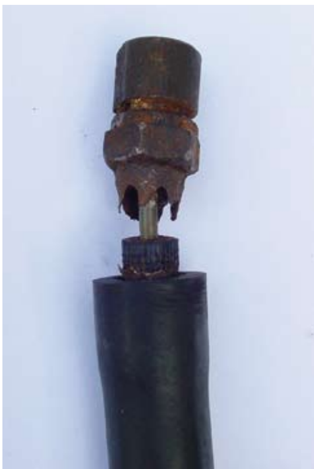
Een doorgeroeste persverbinding
